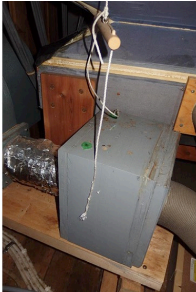
Figur 13. Trasig upphängning av ridåventilen i lådan.
