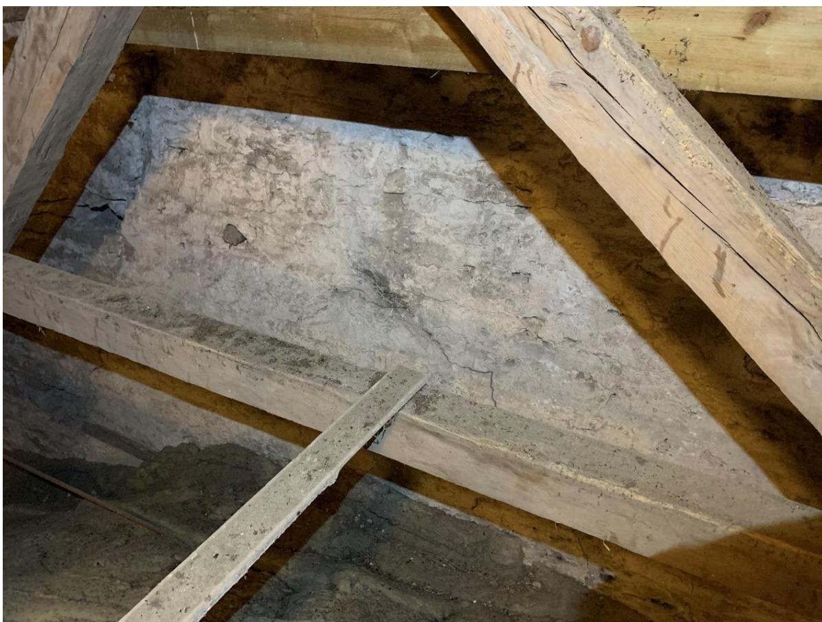
Triumfbågmurens nedre del sedd från långhusvinden med spår av ett äldre gavelröste, som sannolikt ingår i murverket, troligen från ett tidigare långhus. Foto JL 2022.
