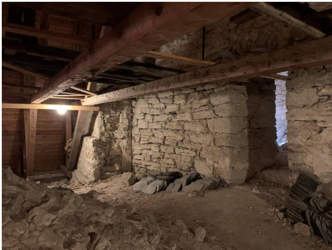
Långhusvinden mot sydväst med tornets östmur och passage från tornets första övervåning. Foto JL 2022.
