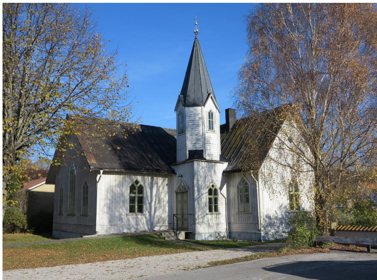
Exteriör från sydväst före ommålningen 2017 men efter att den i bilden ovan från 2002 vita plåtavtäckningen på tornets halvyramider målats svart. Den svarta färgen har dock av okänd anledning även använts på den rektangulära skyddsplåten på väggen. Foto Pär Malmros 2014, Gotlands museum.
