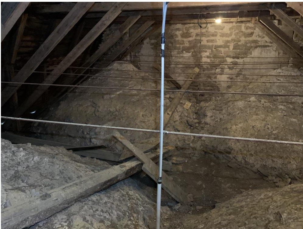
Långhusvinden med valvens ovansida sedd mot väster. I fonden tornets murverk med det romanska långhusets takfall skönjbart som en triangulär skugga. Foto JL 2019.
