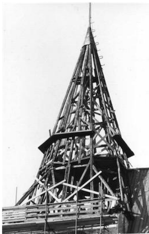
Tornhuvnen från sydöst under restaureringen 1978-80. Foto Gunnar Svahnström ca 1979. Gotlands Museum GFF 940:135.
