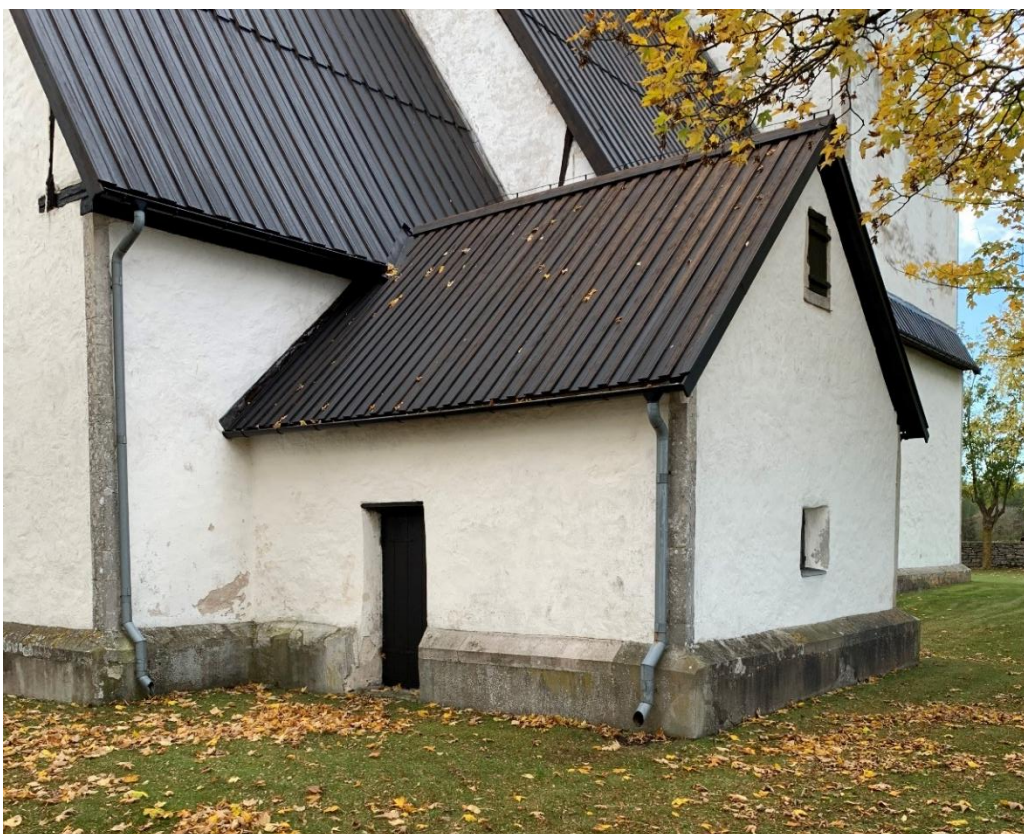
Sakristian från nordöst, troligen från 1600-talets början. Dörren togs upp under sent 1800-tal. Foto JL 2021.
