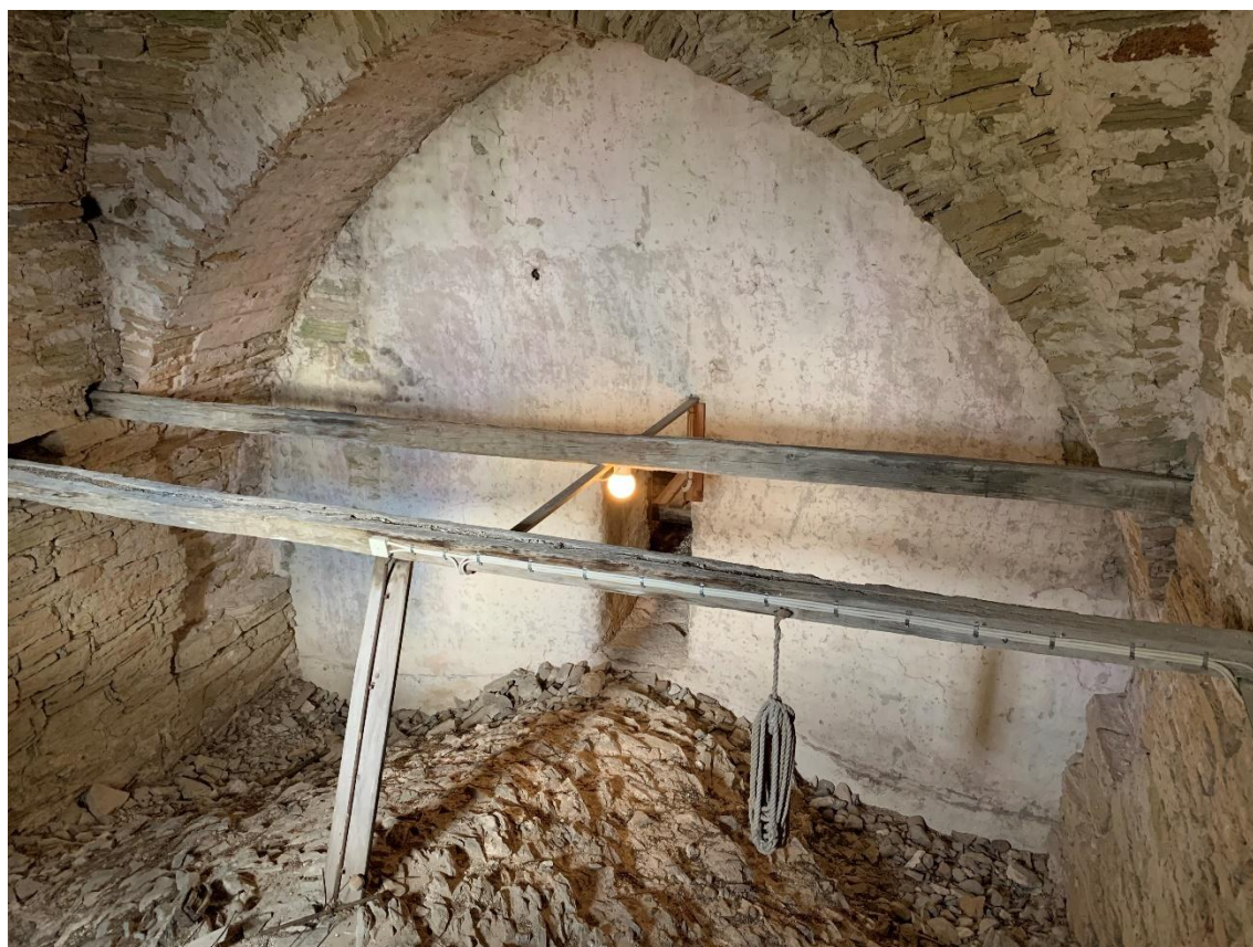
Tornets första övervåning mot nordöst. Muren i fonden utgör ett stycke av långhusets ursprungliga västra gavelmur. Putsen, som fortsätter in bakom tornets murverk, är äldre än tornet och visar att tornet är en senare tillbyggnad och att kyrkan även i sitt äldsta skick var putsad. Linjerna strax ovanför valvets sidor markerar sannolikt nivån på svicklarnas fyllning före 1998. Foto JL 2021.
