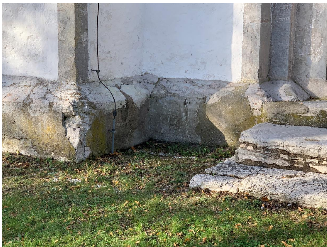
Sockeln i södra hörnet mellan långhus och kor. Sockeln och portalerna visar skador, sannolikt från branden 1676. Foto JL 2021.
