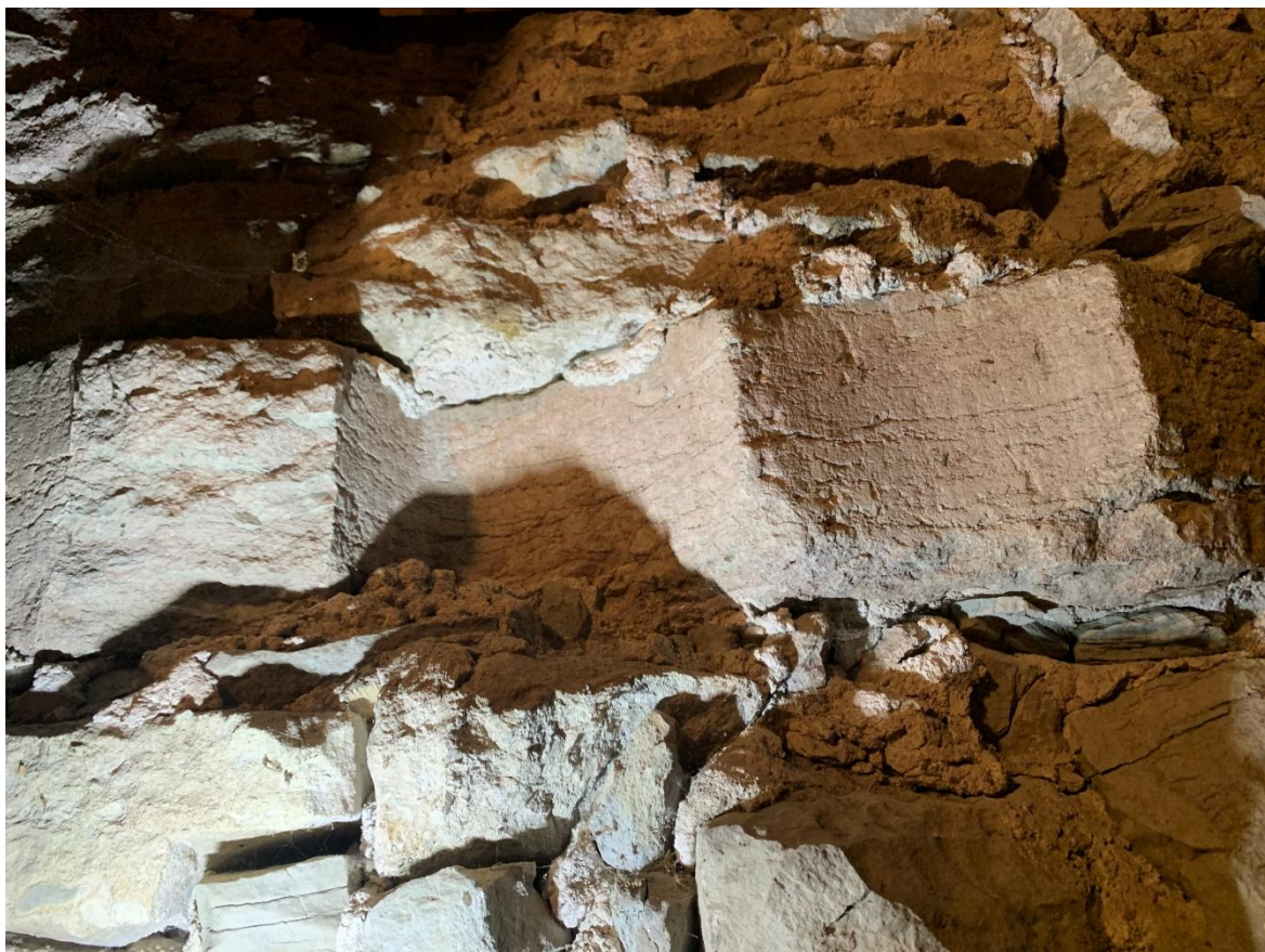
Inmurade delar i övre delen av tornets norra gavelröste från ljudgluggarnas masverk. Foto JL 2023.
