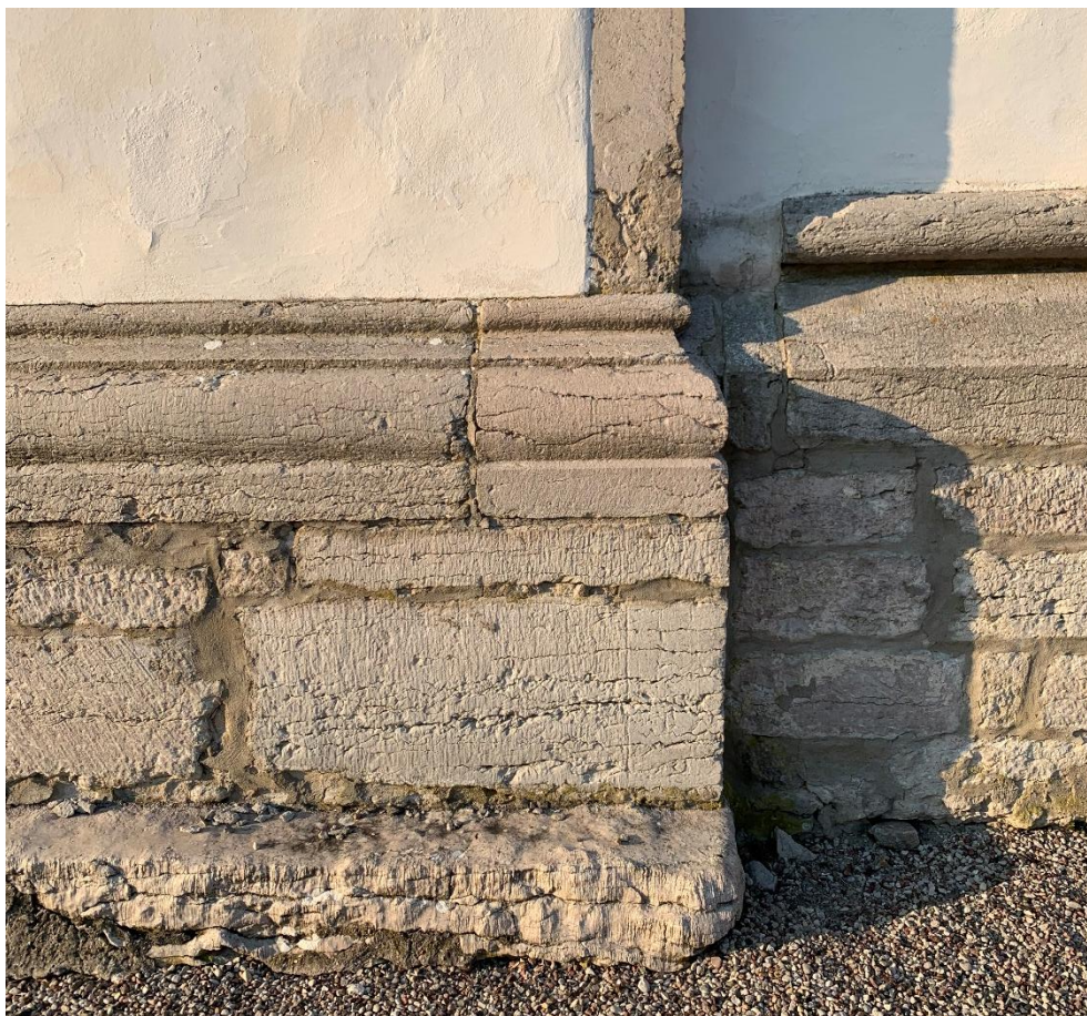
Möte mellan sockeln på långhusets västra och östra del. Foto JL 2022.
