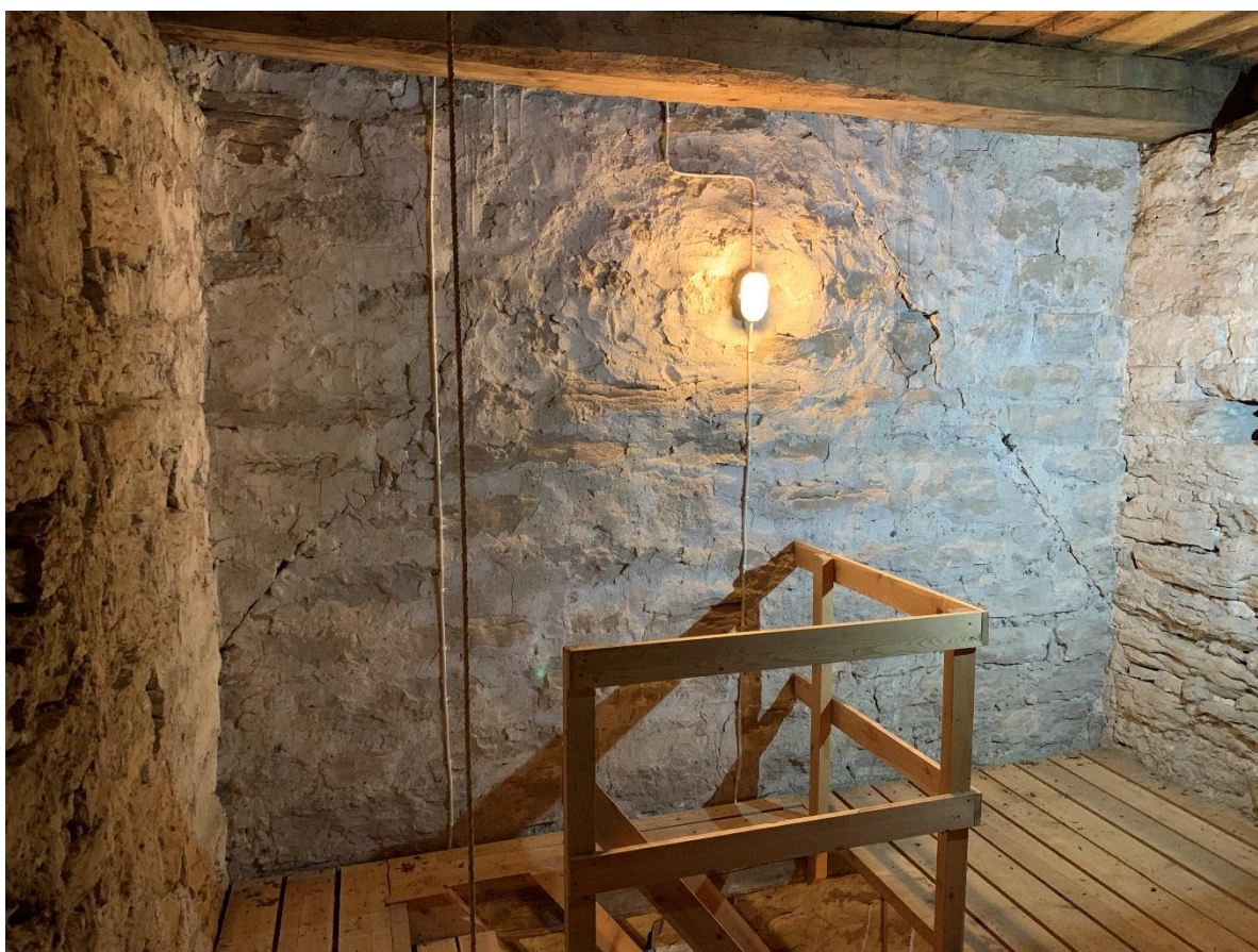
Tornets andra övervåning mot öster med spår av att det äldre långhusets gavelröste. Foto JL 2022.
