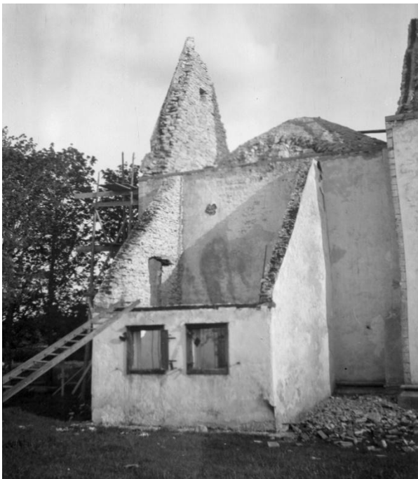
Exteriör av tornet och sakristian från nordöst och nordväst efter brand. Foto 1909 i ATA. Genom ett blixtnedslag i mars 1908 uppstod en brand som förstörde yttertaken. Kyrkorummet klarade sig, liksom tornet nedanför klockvåningen genom att det murade valven höll emot elden, men sakristian, vars innertak var av trä, blev utbränd. På de gamla murarna återuppbyggdes yttertaken, tornspiran och sakristians inredning 1909 samtidigt som kyrkan i övrigt restaurerades. Bilden av tornet visar att ljudgluggarna i öster och norr inte hade förändrats som de i söder.
