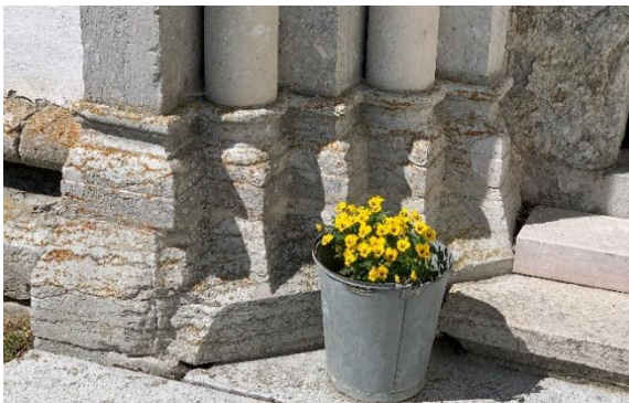
Långhusportalens västra och östra kapitälband samt det västra basbandet. Foto JL 2021.
