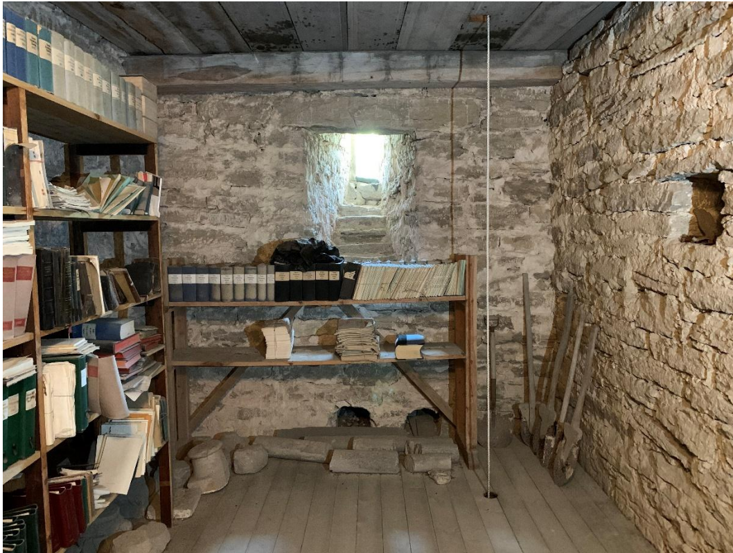
Tornets första övervåning mot söder. Två muröppningar vid golvet efter tidigare bjälkar saknar motsvarighet på norra sidan. Foto JL 2021.
