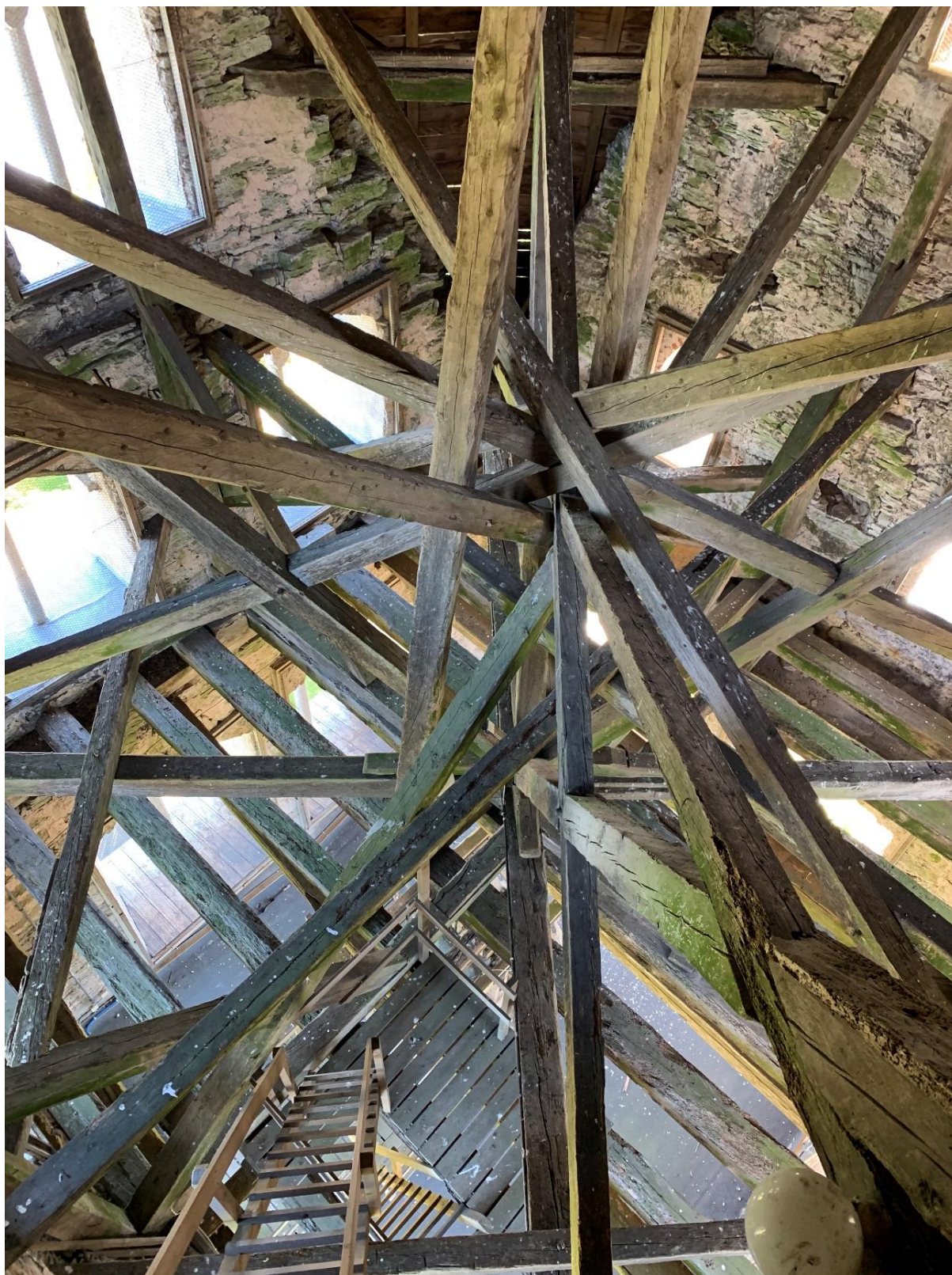
Tornhuvens bärverk sett uppifrån mot sydöst visande det typiskt gotländska draget att huvan saknar hjärtstolpe. Foto JL 2021.
