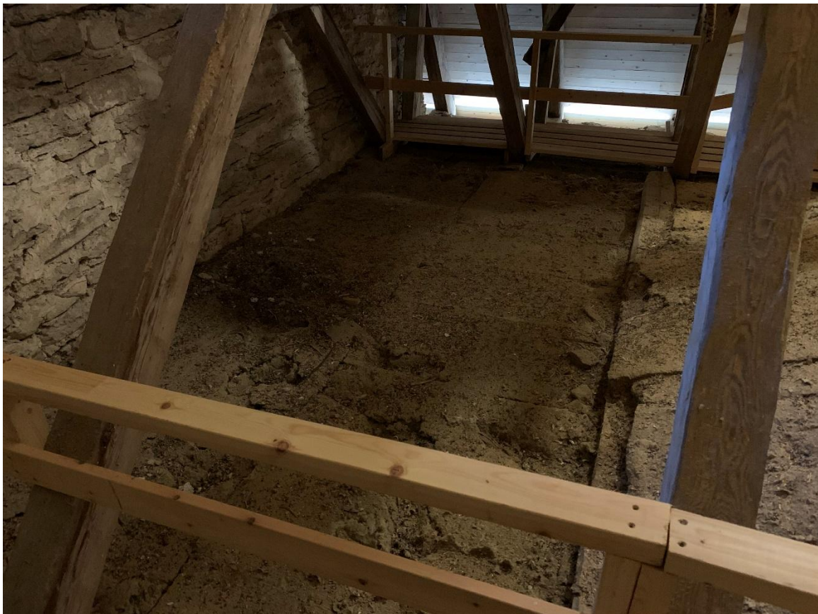
Korvindens östra del rakt över den inbyggda absiden. Isoleringsullen inlagd 1978-1980. Foto JL 2021.
