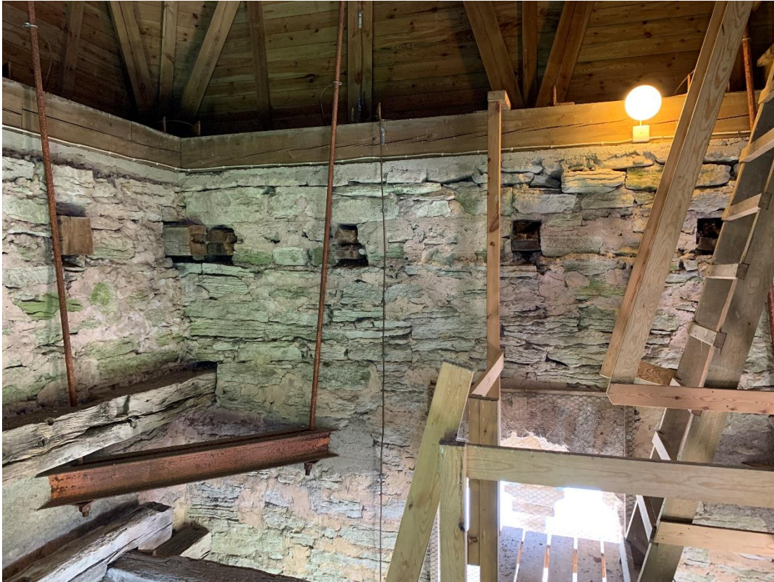
Tornets murkrön sett mot öster med rester av äldre bjälklag från en tidigare förändring av murkrönet samt en avjämning i betong och förstärkning av hörnen med järnbalkar 1970-71. Foto JL 2021.
