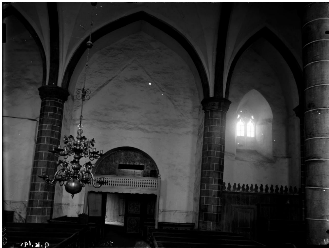
Interiör mot väster före restaureringen 1895. Fönstret är igensatt utom de delar som åter togs upp på 1728. Skärmväggen till höger är målad mörk. Foto Olof Sörling ca 1890, ATA, RAÄ.
